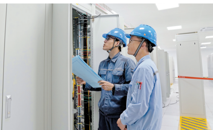
钦州供电局变电管理二所工作人员对广西华谊三期项目第二回路电源工程继电保护设备型号、接线等进行现场核对。 翟晋升 摄
